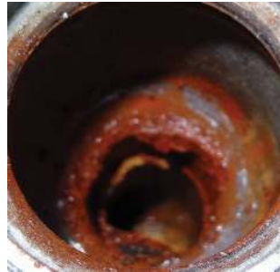
Derselbe Rohrstück 14 Monate nach der Installation des Aqua4D® Systems
