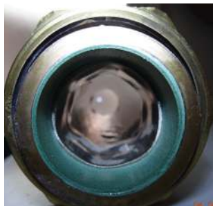
Das Kontrollrohr 24 Monate nach der Installation von Aqua4D®
