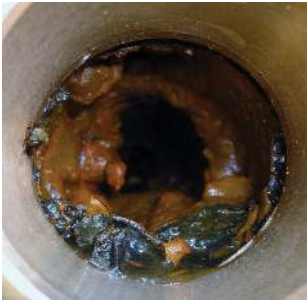
Zustand der Kaltwasserleitung vor der Installation des Aqua4D® Systems
