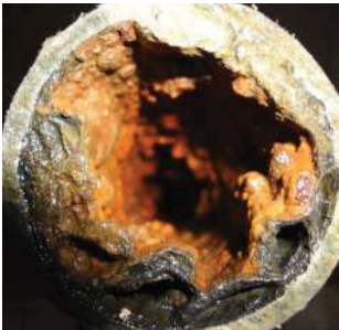
Zustand der Kaltwasserleitung vor der Installation des Aqua4D® Systems
