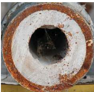
Foto der Kaltwasserleitung vor der Installation von Aqua4D®
