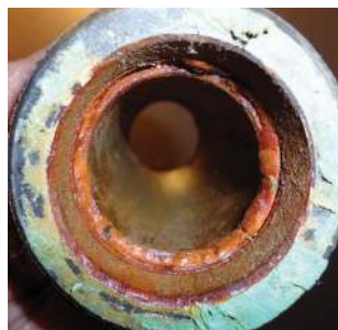
Dasselbe Rohrstück 36 Monate nach der Installation des Aqua4D® System
