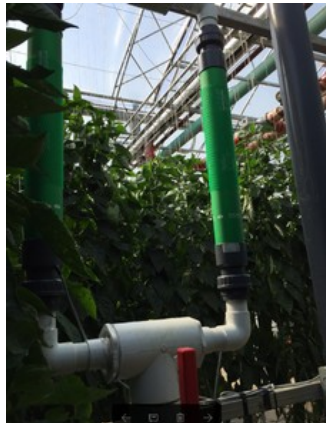
Tubos de Aqua4D en una operación canadiense del invernadero.
